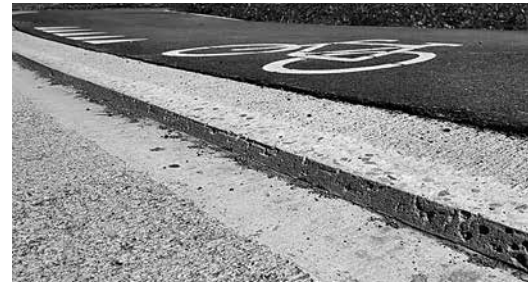
Absatz beim Kreisverkehr Fadenbrücke – einfach unbrauchbar!
